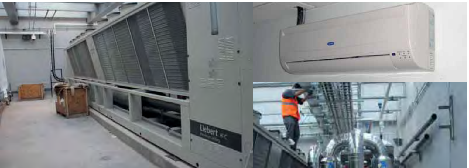
Foto Chillers 400 TR Centro de Datos Hermosillo
