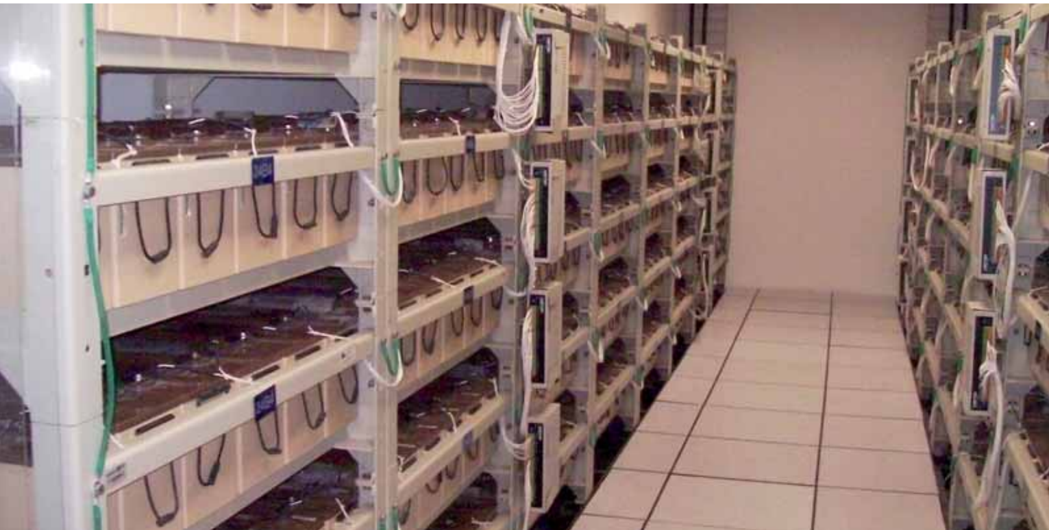
Foto Cuarto de UPS Hermosillo
