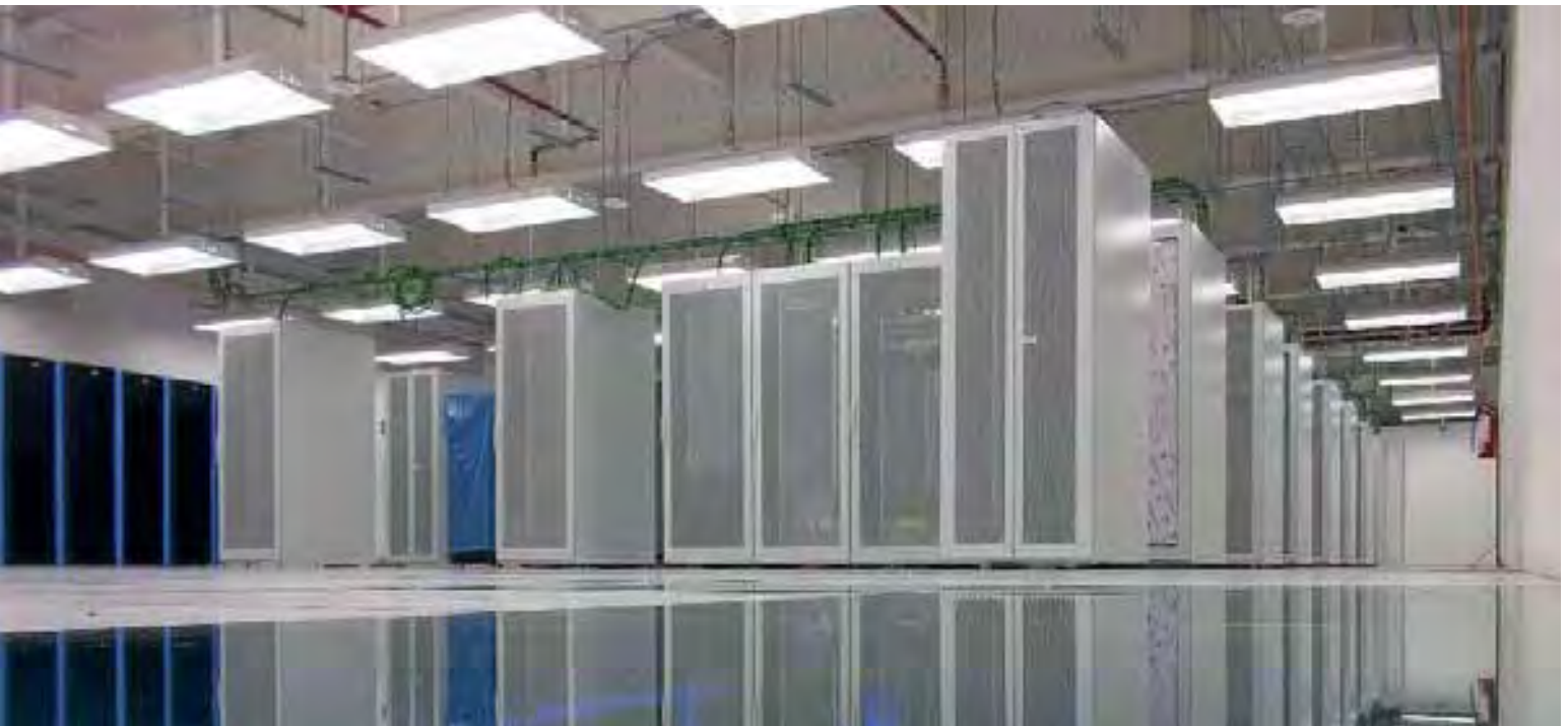
Foto Centro de Datos Hermosillo
